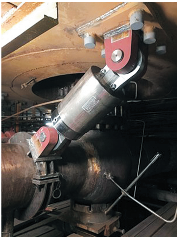
Рис. 3. Смонтированный гидроамортизатор на главном циркуляционном трубопроводе [Fig. 3. Mounted shock absorber on the main circulation pipeline]
